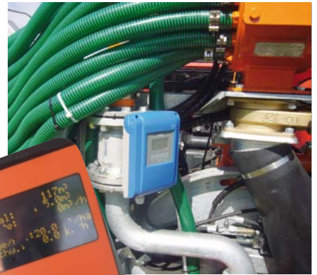
Durchflussmengenmessung für bessere Übersicht
